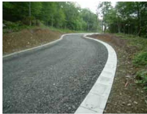
L型側溝の施工状況 川井・住田線 横沢・荒川区間(岩手県)
