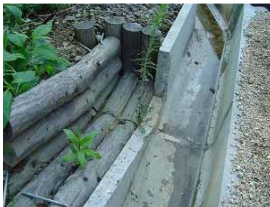
脱出用スロープを設置した側溝 (美濃東部区域：岐阜県)
