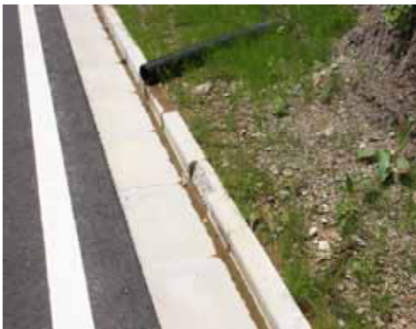
L型側溝(這い上がり)の施工状況 大朝・鹿野線 戸河内・吉和区間(広島県)
