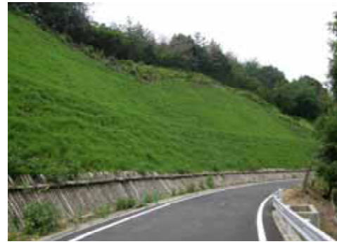
丸太法面伏工の施工状況 宇目・小国線 宇目区間(大分県)
