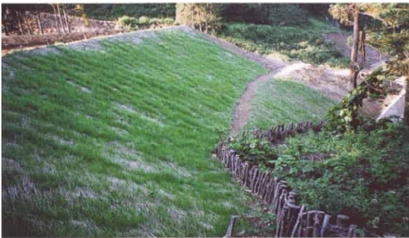
むしろ張芝工及び粗朶柵の施工状況 飯豊・檜枝岐線 田島・館岩区間(福島県)
