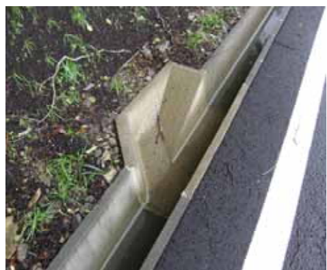
スロープ付き側溝の施工状況 菊池・人吉線 泉・五木区間(熊本県)
