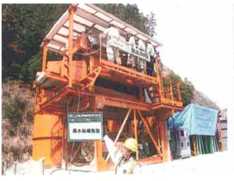
濁水処理装置 広見・篠山線 松野・鬼が城区間(愛媛県)
