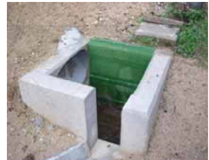
メッシュシートを設置した集水枡 ( 邑智西部区域：島根県 )
