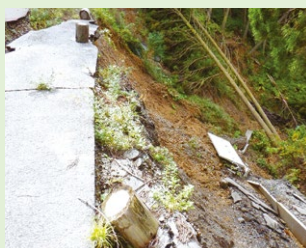
道の半分が崩れ落ちた林道
