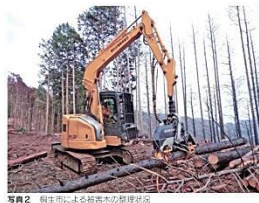
写真2 桐生市による樹木の整理状況
