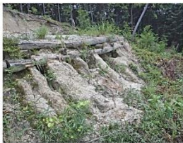
写真1 マサ土地域における法面露出
