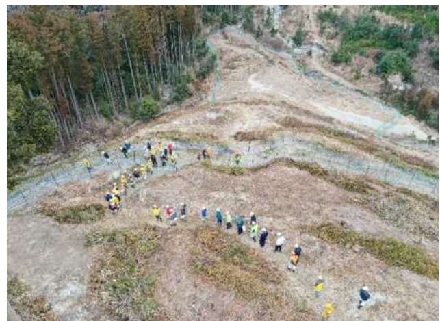
ケモノ道を残置する防護柵(ブロックディフェンス) についての現地検討(中部整備局)
