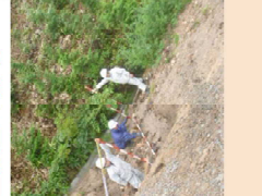
○盛土法面の崩壊
