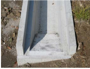
写真1. 側溝端部這い上がり
