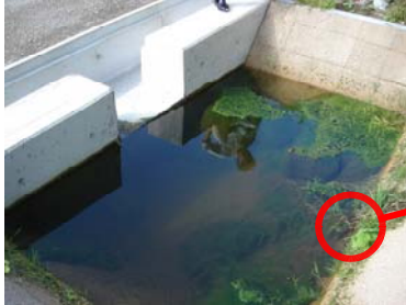
写真4. 側溝脇の集水施設
