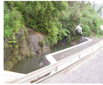
写真3. 側溝脇の集水施設
