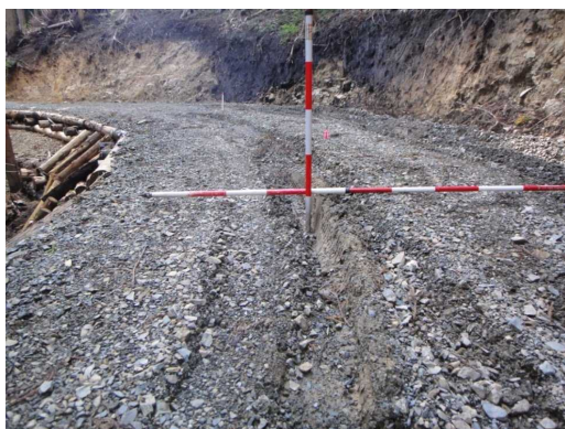
写真－5 碎石の沈み込み状況
