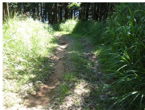
路面洗掘・ 植物の侵入
