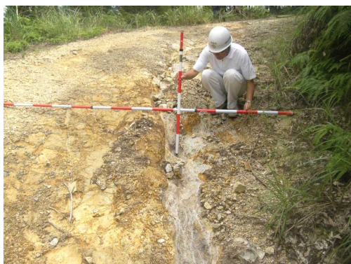
路面洗掘状況
