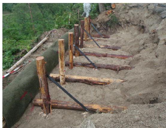
写真-9：下段柵吸出防止材および上段柵横木・杭木設置状況
