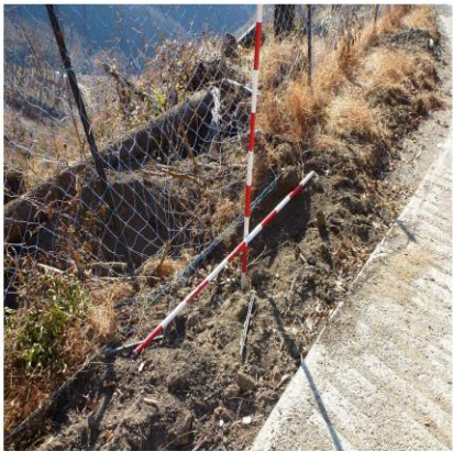
イノシシによる被害状況
