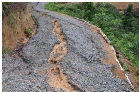
図 1 路面洗掘の被害例
