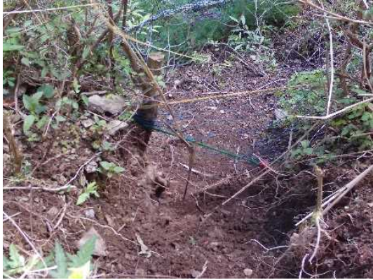
防護ネット下部の浮き上がり
