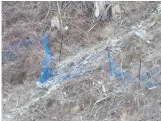
崩土による防護ネットの破損
