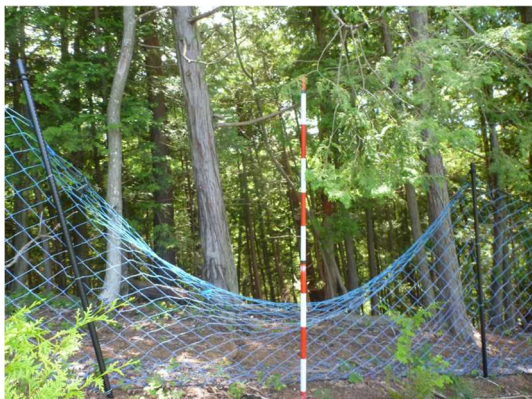
張りロープの弛み
