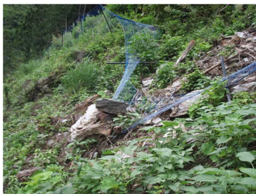
【落石による破損】
