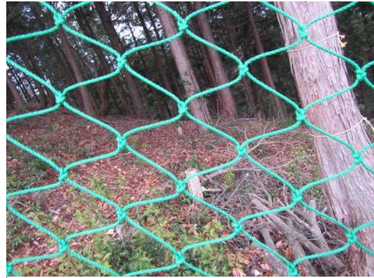
【水平方向に張りすぎている網目】 防護ネット下部が浮き上がり易くなる
