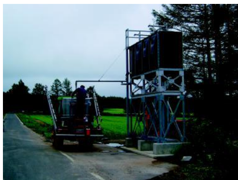
ほ場近くに設置された給水栓
