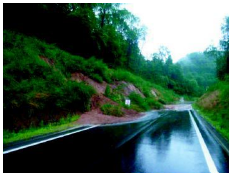
被災した農林業用道路（5工区）
