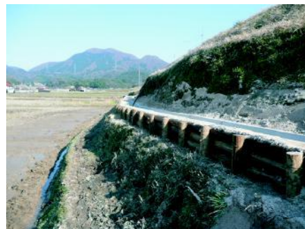
農業用排水路を保護する土留柵 (阿蘇西部区域)
