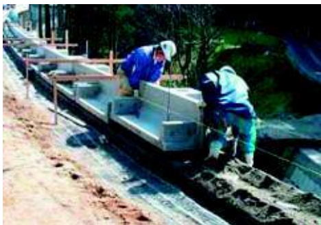
プレキャストガードレール基礎（施工中） （阿蘇小国郷区域）
