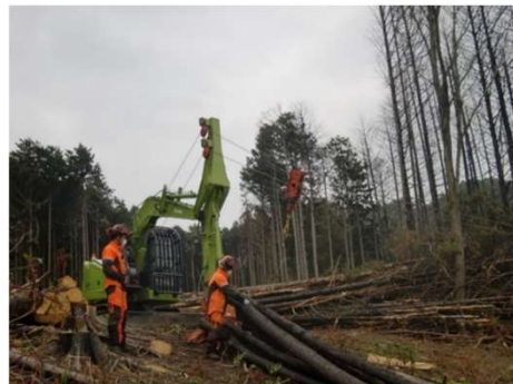
写真5 桐生市による被害木処理の状況
